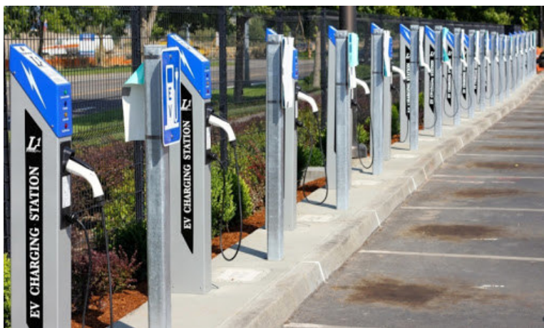
Εικόνα 26: Παράδειγμα υπαίθριου σταθμού φόρτισης ηλεκτρικών οχημάτων.
