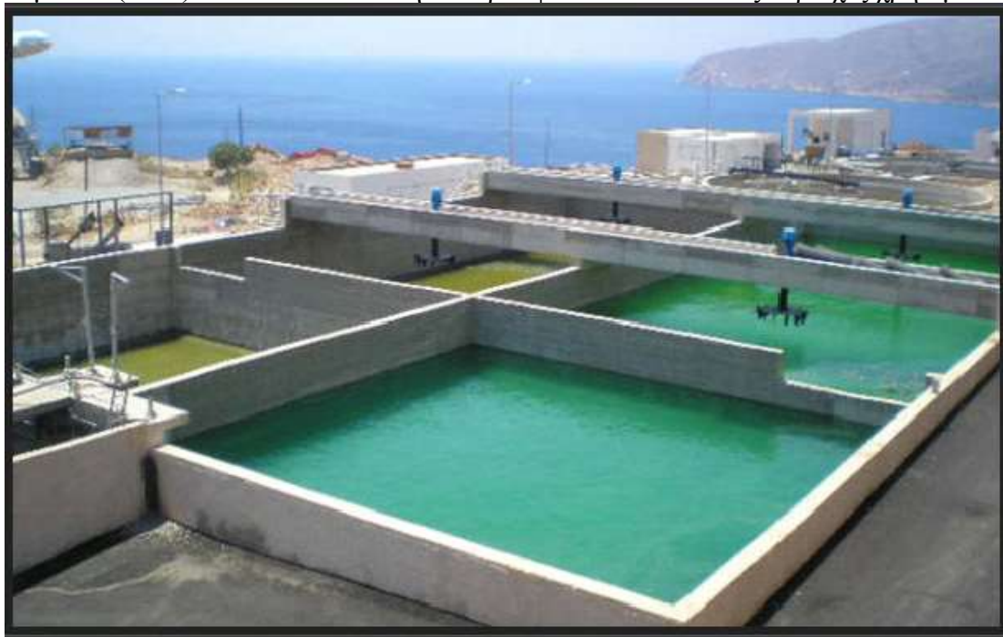
Εικόνα 2-1: Εγκαταστάσεις επεξεργασίας λυμάτων
