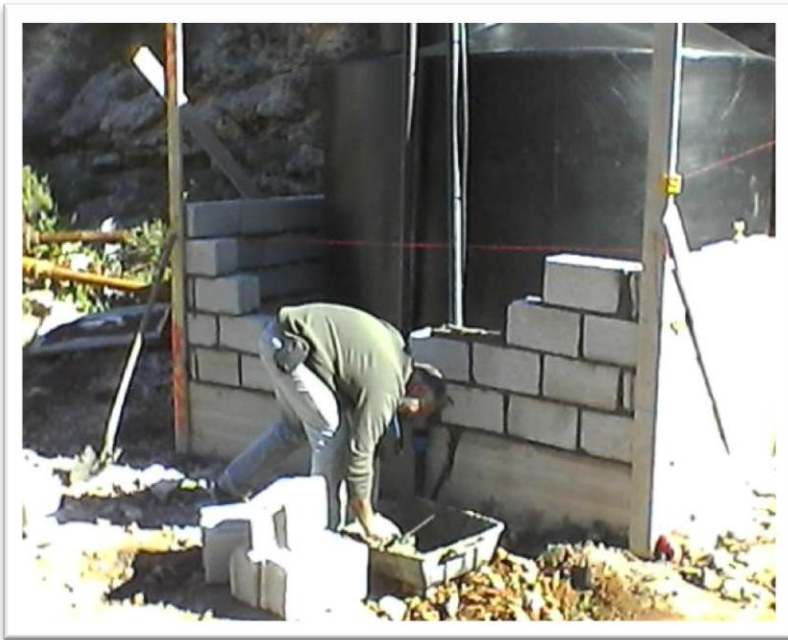
Νέα δεξαμενή ύδρευσης στα Αργινώντα
